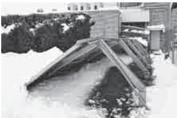
▲雪の重みで潰れたカーポート
