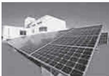
▲屋上には太陽光発電設備
