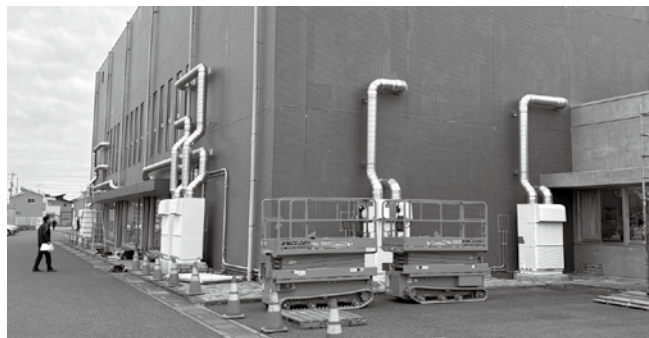
月の輪小学校空調設備の室外機
