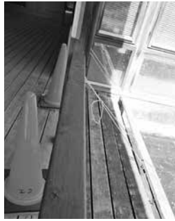
老朽化が進むデッキ(東側)
