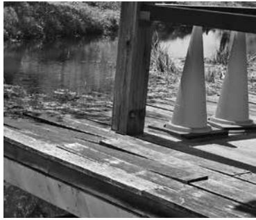
老朽化が進むデッキ(南側)
