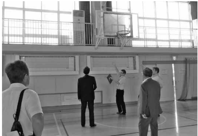
滑川中学校体育館 空調設備
