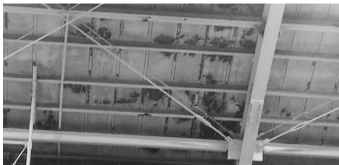
宮小体育館天井の劣化状況 2024年3月
