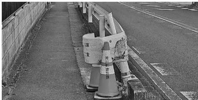
町道159号線:事故により破損したガードレール
