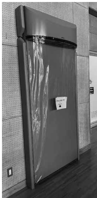
月の輪小体育館の空調機器（宮前小にも同様の機種を設置予定）
