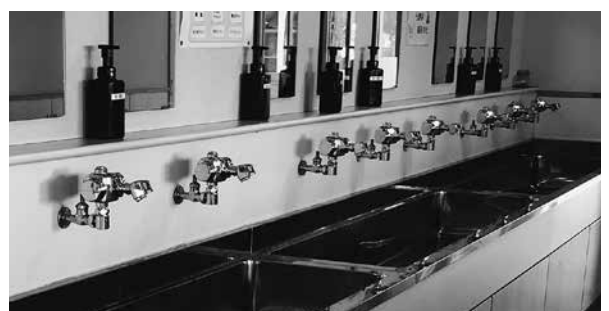
自動水栓に付け替えられた水道(滑川中学校) 小中学校4校総額費用798万円、自動水栓1つあたり29,700円
