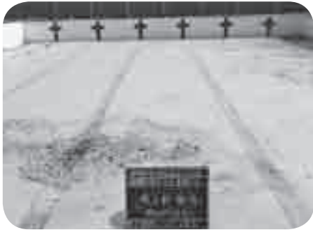
福小プール内部より漏水
