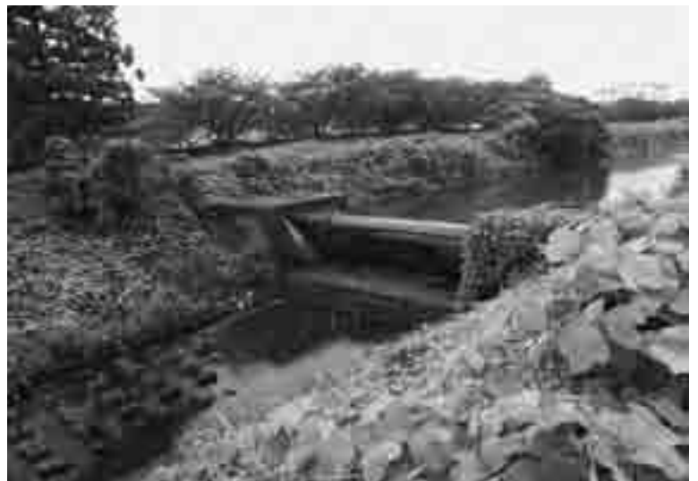
老朽化が進む羽尾平ラバー堰
