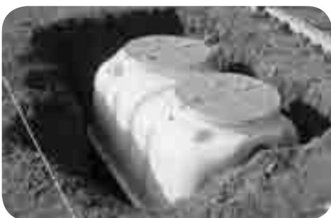
合併処理浄化槽
