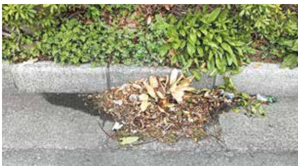
【グレーチング清掃前】
